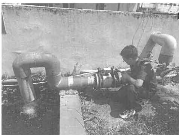
(9)打开应急池阀门导入消防废水到应急池
